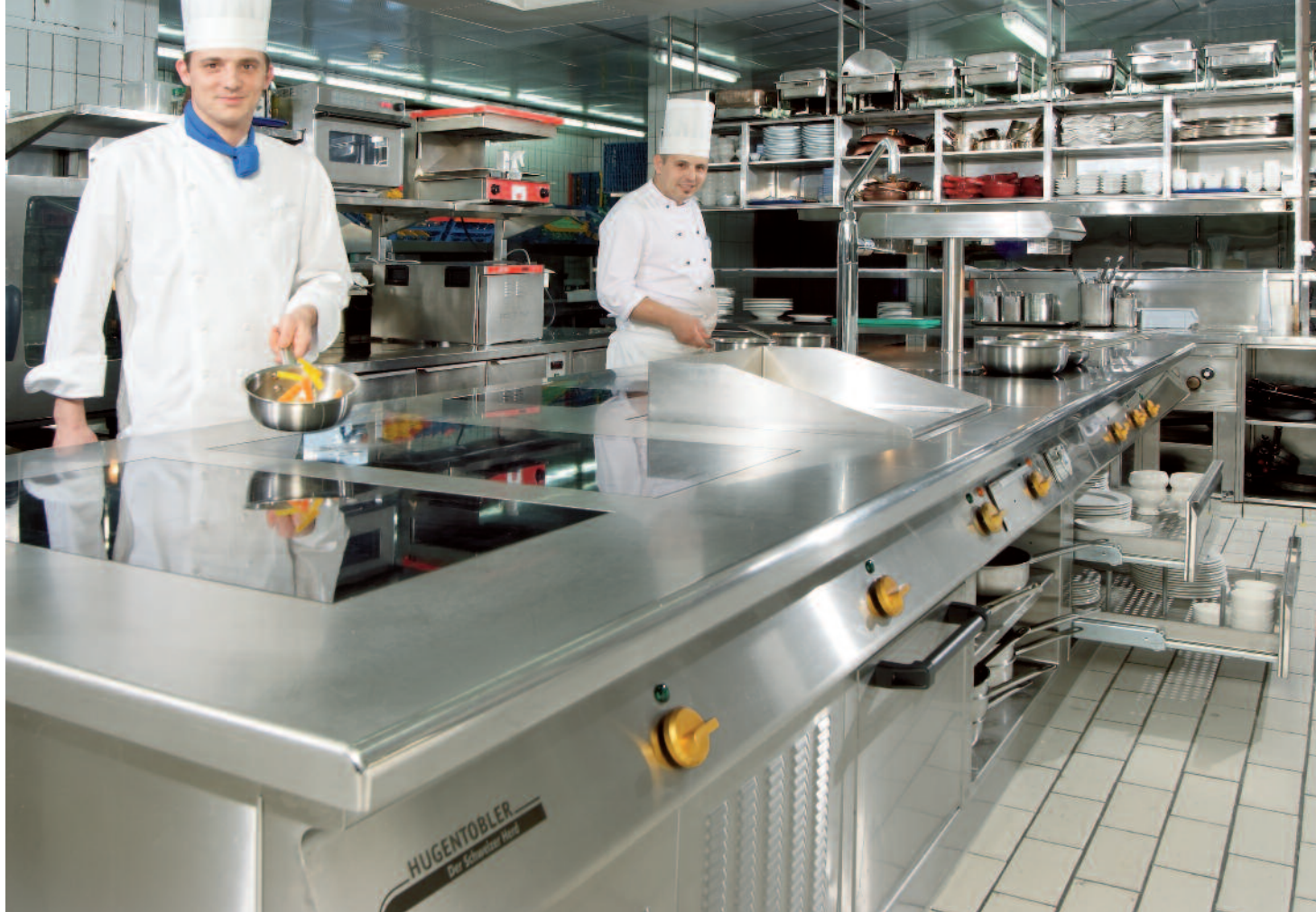
Die neue individuell aufgebaute Herdanlage in der Küche des Metropole Hotels Interlaken: Die beiden Chefs Marco Hächler und Jürgen Wind wissen die massgeschneiderte Konfiguration und die Effizienz zu schätzen.
