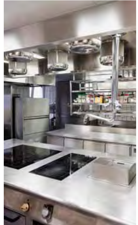
Die neue Restaurationsküche des Zunfthauses zur Waag
